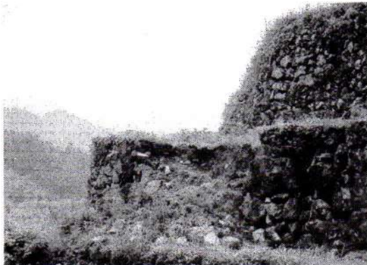
広内地区での石垣の崩壊
