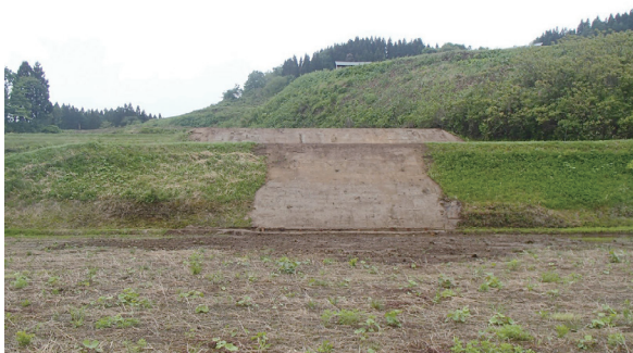
悩みの種、法面崩壊
