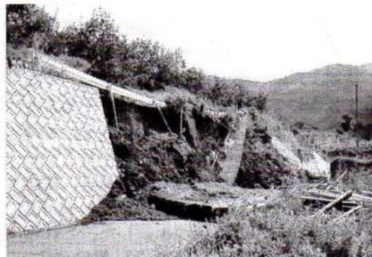
写真-6 道路山留め壁の崩壊
