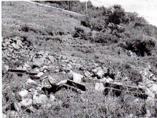
写真-5 水路の崩壊
